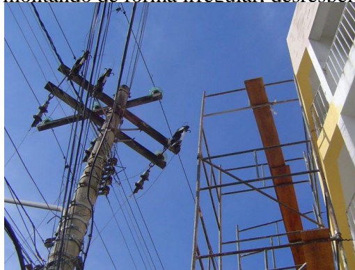
Figura 2 – Andaime montado de forma irregular, desrespeitando a zona de risco.
