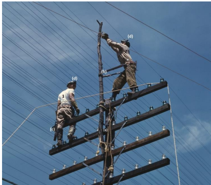
Figura 3 – Trabalhadores 1 e 2 em local com inconformidades: (a) “dispositivo de segurança” instalado de forma inadequada, (b) cinto de segurança usado de forma incorreta, (c) sinto de segurança solto, (d) ausência de capacete e óculos de proteção.
